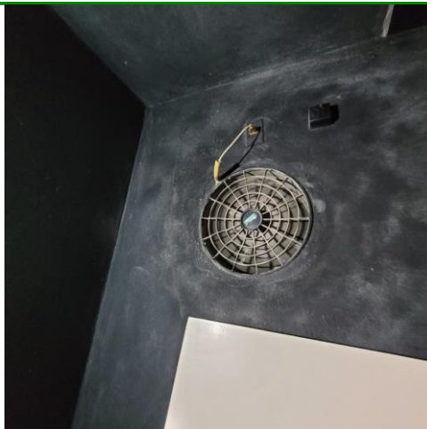
31.19. Sala de Revelação do Raio-X com exaustão insuficiente
