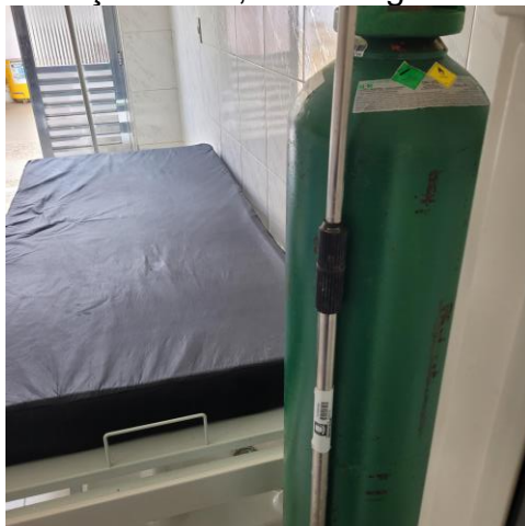
31.9. Maca comum na suposta "Sala Vermelha". Na frente a porta de alumínio permite entrada direta de maca da ambulância na Sala. Cilindro de Oxigênio sem fixação
