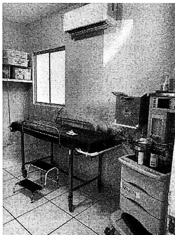
30.16. Sala Vermelha com 1 leito split e mofo
