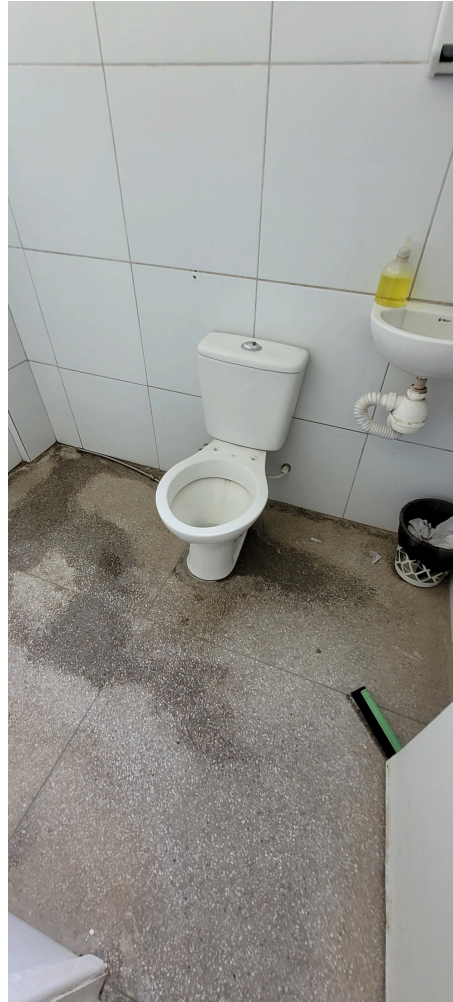
banheiro de funcionários masculino com vaso sanitário sem tampa
