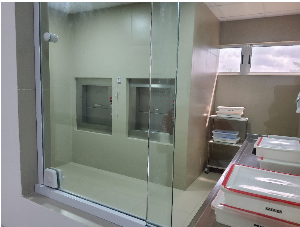
Expurgo (monta-carga leva para o segundo andar)
