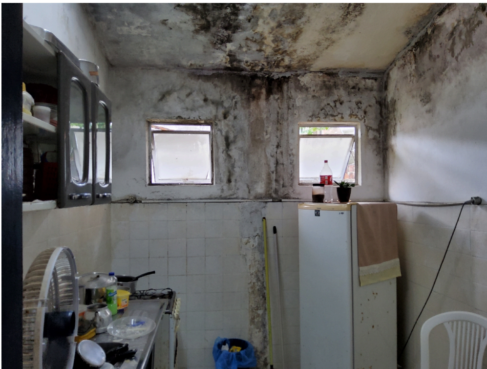
Cozinha (observar infiltração)
