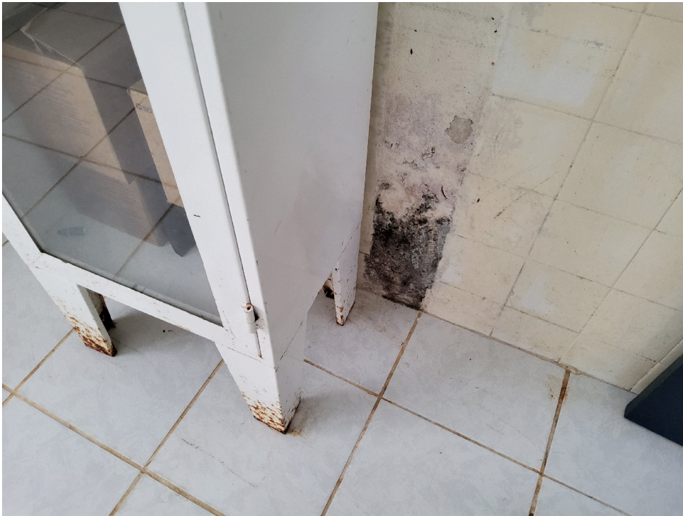
Infraestrutura precária da sala de vacina
