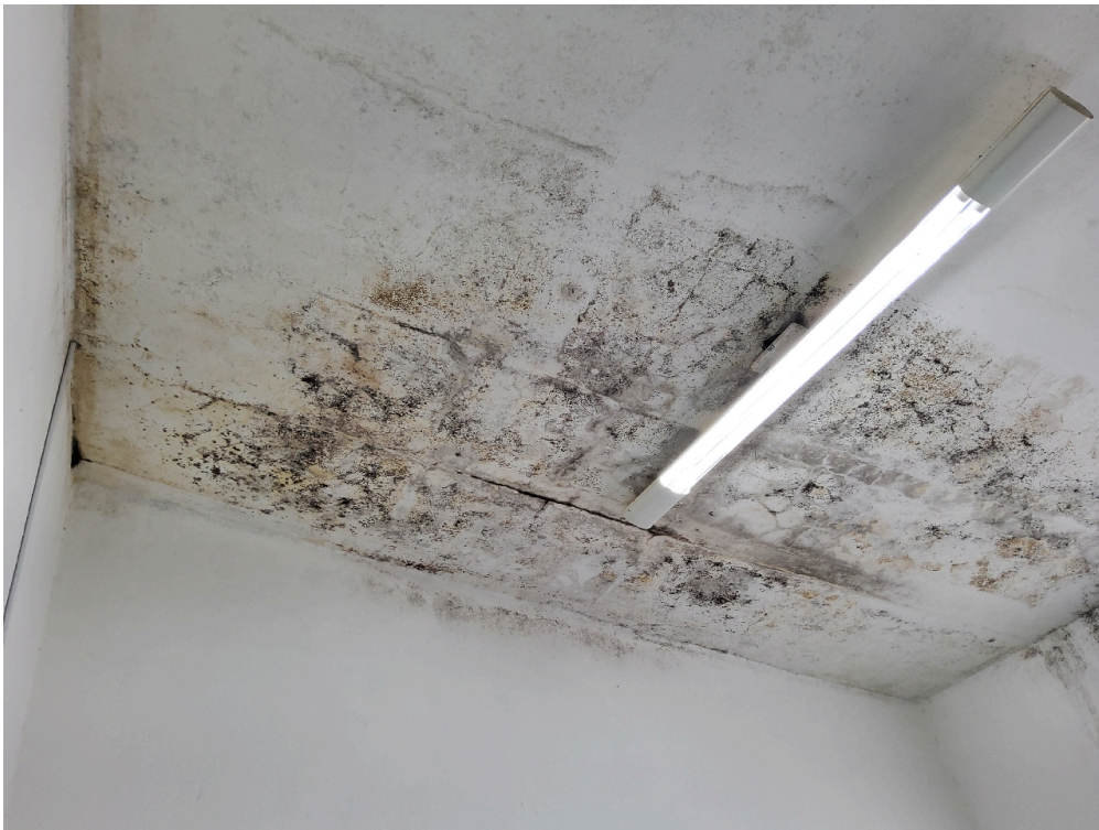
Infiltração no teto da sala do dentista
