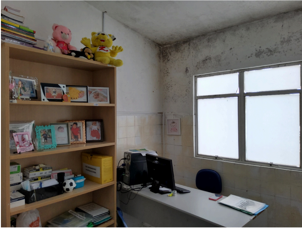
Sala da enfermeira com infiltração (foto 1)
