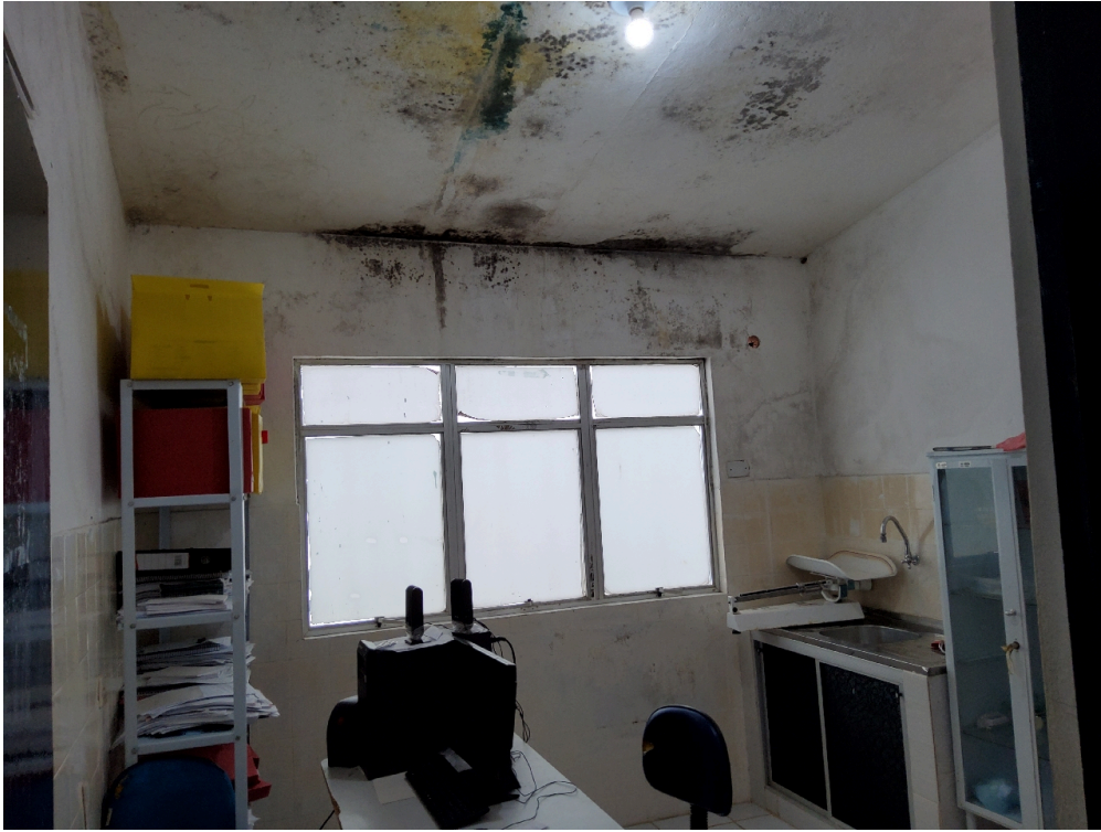
Consultório médico (observar infiltração)
