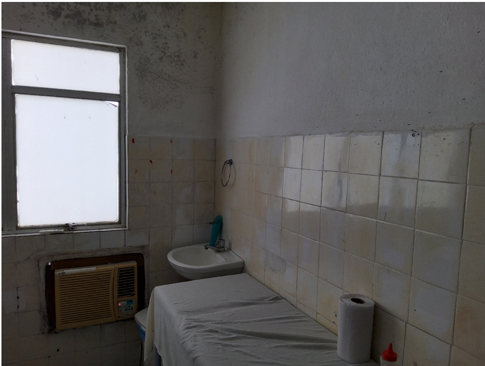
Sala da enfermeira com infiltração (foto 2)
