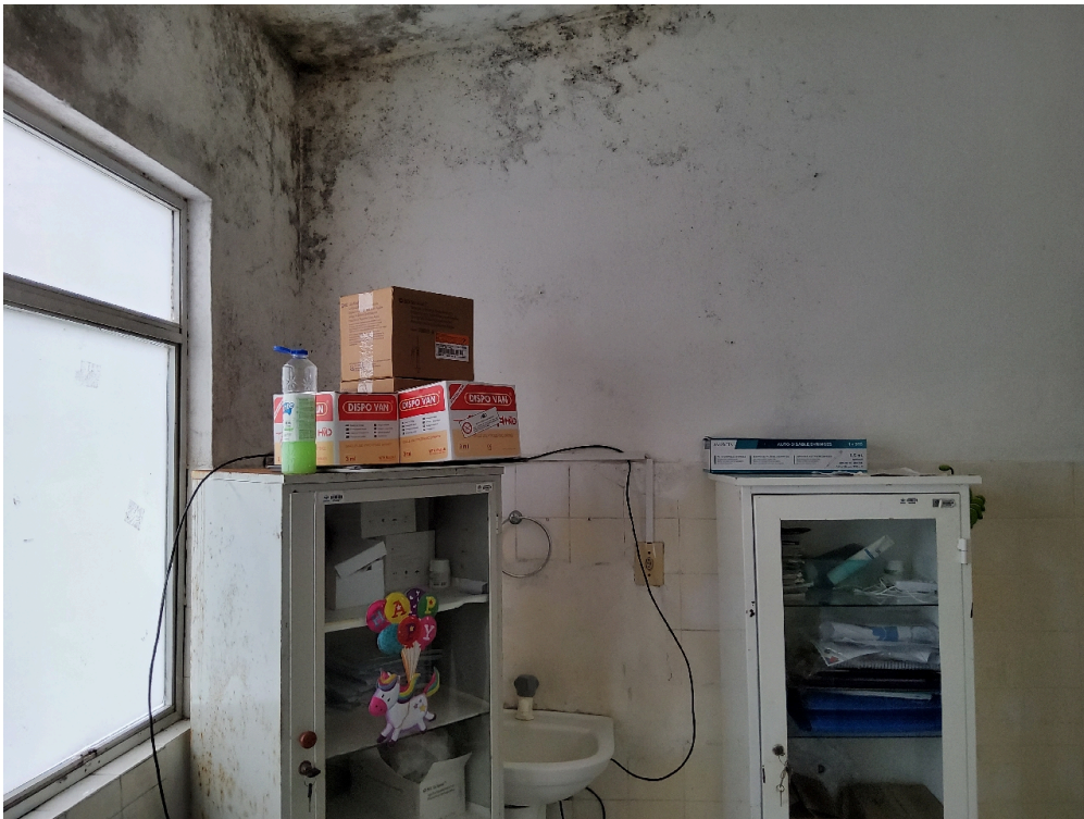
Sala da vacina (observar infiltração)
