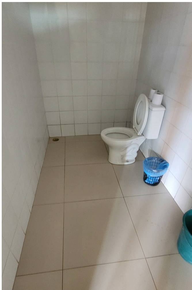
banheiro para usuários masculinos na recepção sem barras de segurança não garante acessibilidade para pessoas com deficiência - PCD
