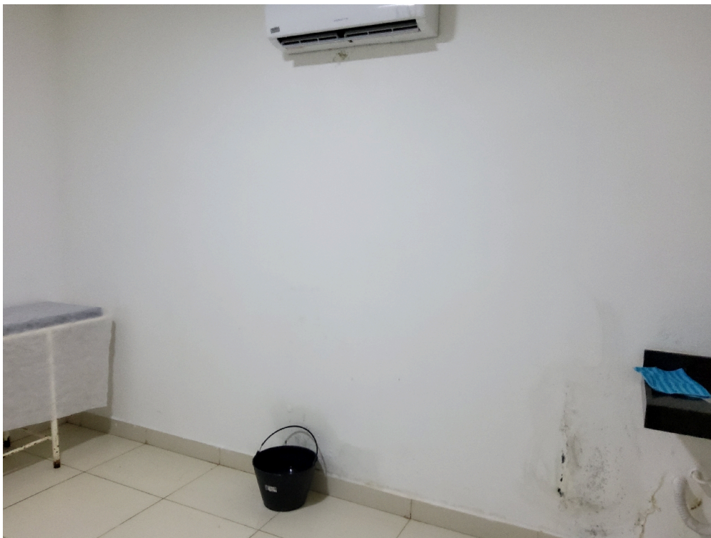
Consultório médico (foto 2 - observar infiltração e ar-condicionado pingando)
