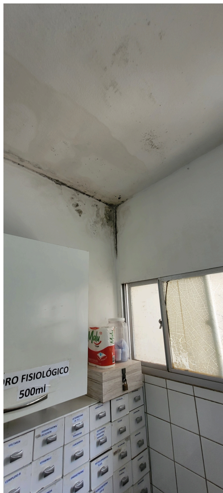
parede e teto da sala de medicações com infiltração e mofo
