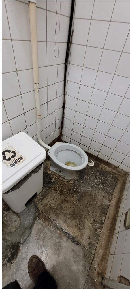
banheiro masculino para paciente da sala de espera com vaso sanitário sem tampa
