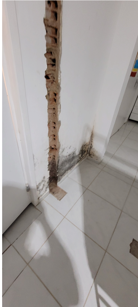
alvenaria exposta, infiltrações e mofo na sala de observação pediátrica
