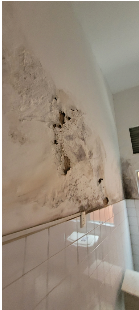
área com infiltrações e mofo
