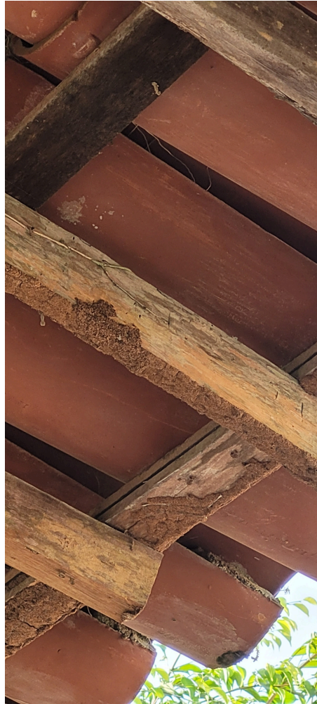
caminhos de cupim verificados na porta de entrada
