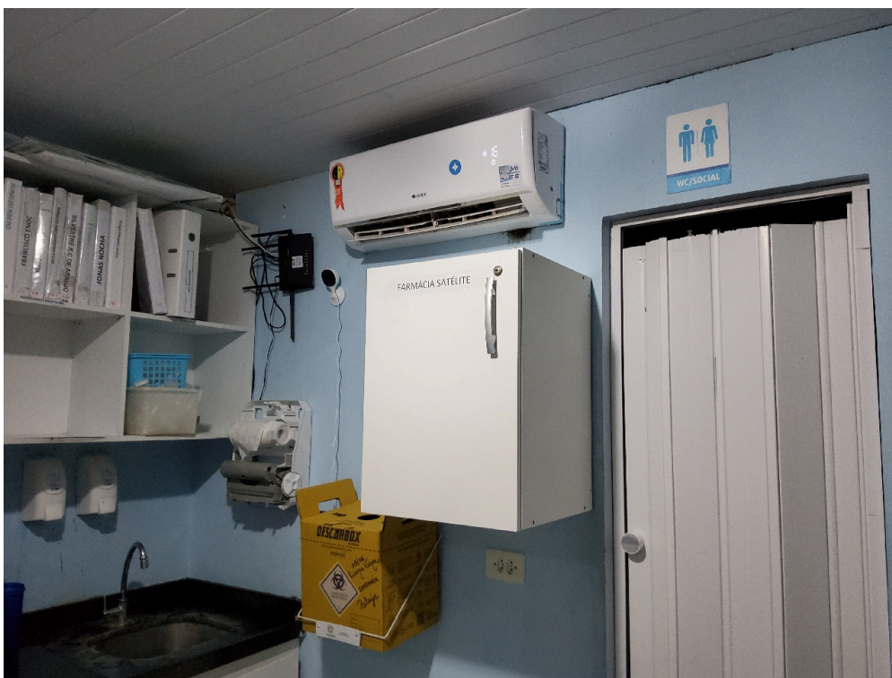
Item não conforme: 1 posto de enfermagem a cada 30 leitos
