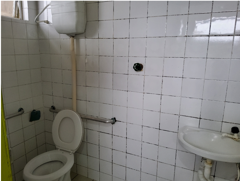
Banheiro adaptado para portadores de necessidades especiais
