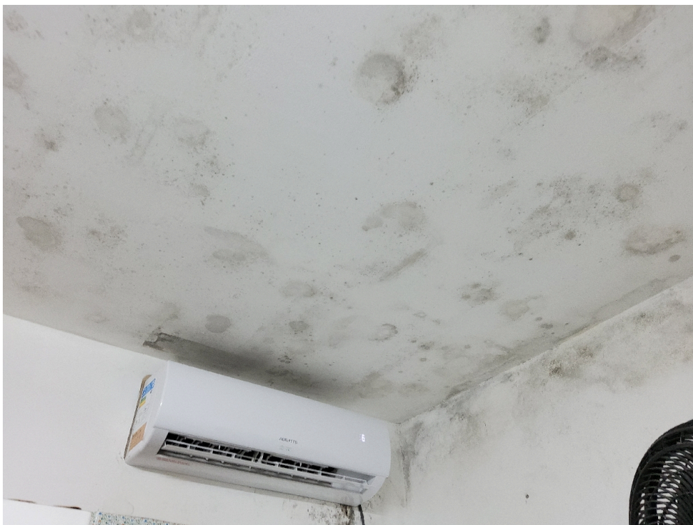
Infiltração no teto do consultório
