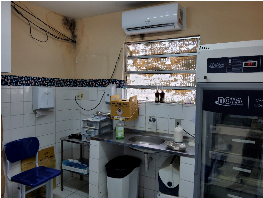
Sala de vacina (foto 1) - observar infiltração
