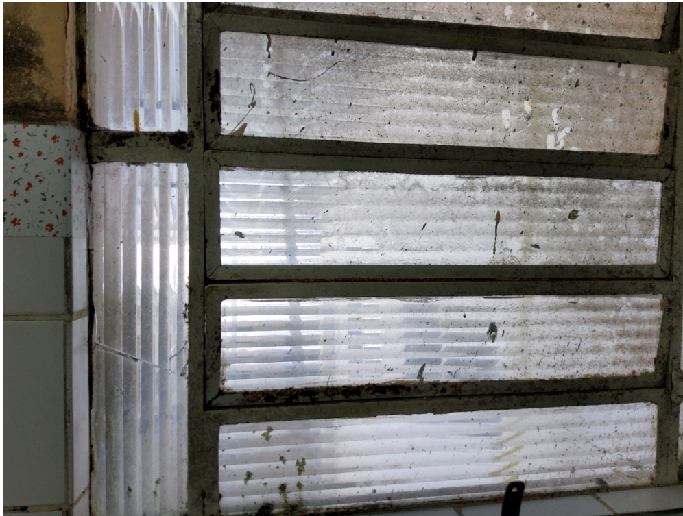
Janela do consultório 2 (observar vidro quebrado)
